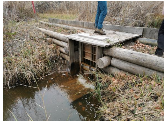
Figure 35 : Gestion des flux d'eau dans une zone humide alluviale de Chautagne (Savoie).
