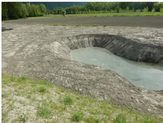
Figure 65 : Déblaiement insuffisant sur une zone humide alluviale dans le Grésivaudan (Isère). Le remblai a simplement été raclé en surface suite à une mauvaise compréhension du cahier des charges entre l'entreprise qui est intervenue et le maître d'ouvrage.
